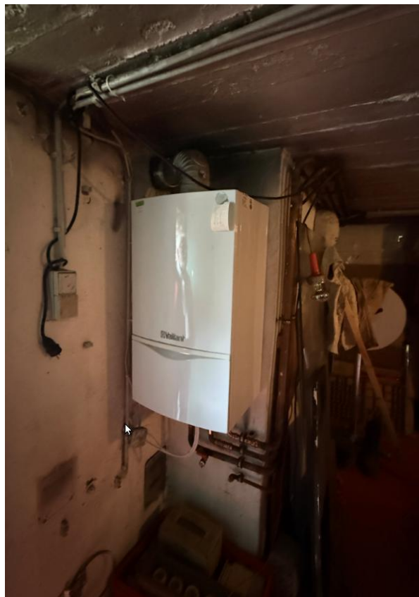
Abbildung 12 Niedertemperaturkessel Keller Haus 3 - Gerberei
