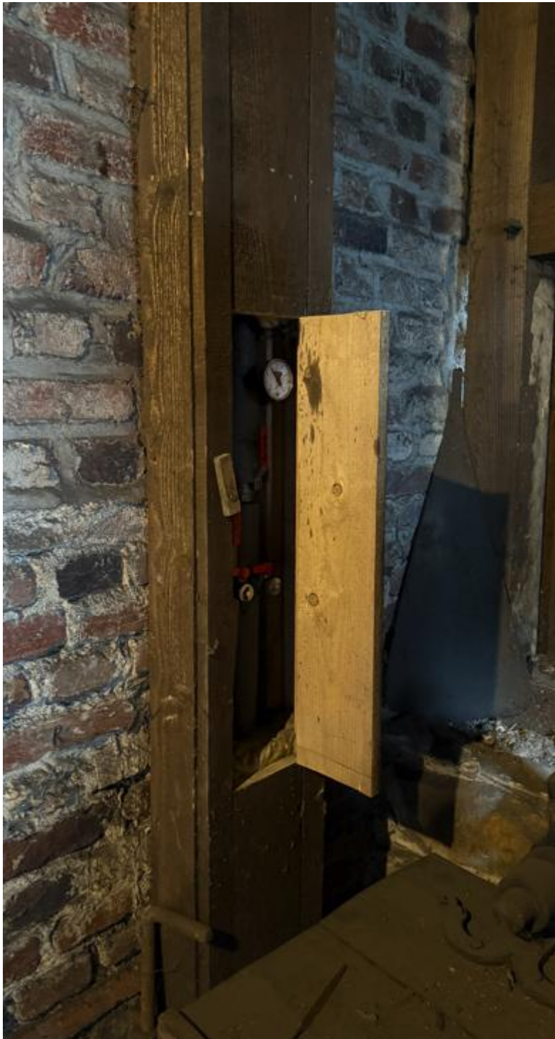
Abbildung 16 Ankommende Nahwärmeleitung im Raum Hammerwerk
