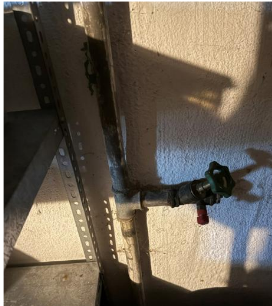
Abbildung 11 TW Installation Haus 3 – Gerberei, veraltet
