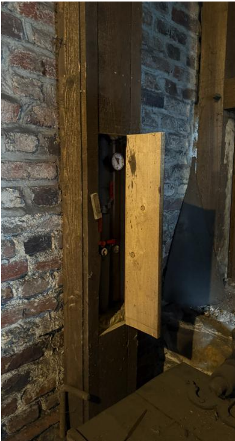
Abbildung 16 Ankommende Nahwärmeleitung im Raum Hammerwerk
