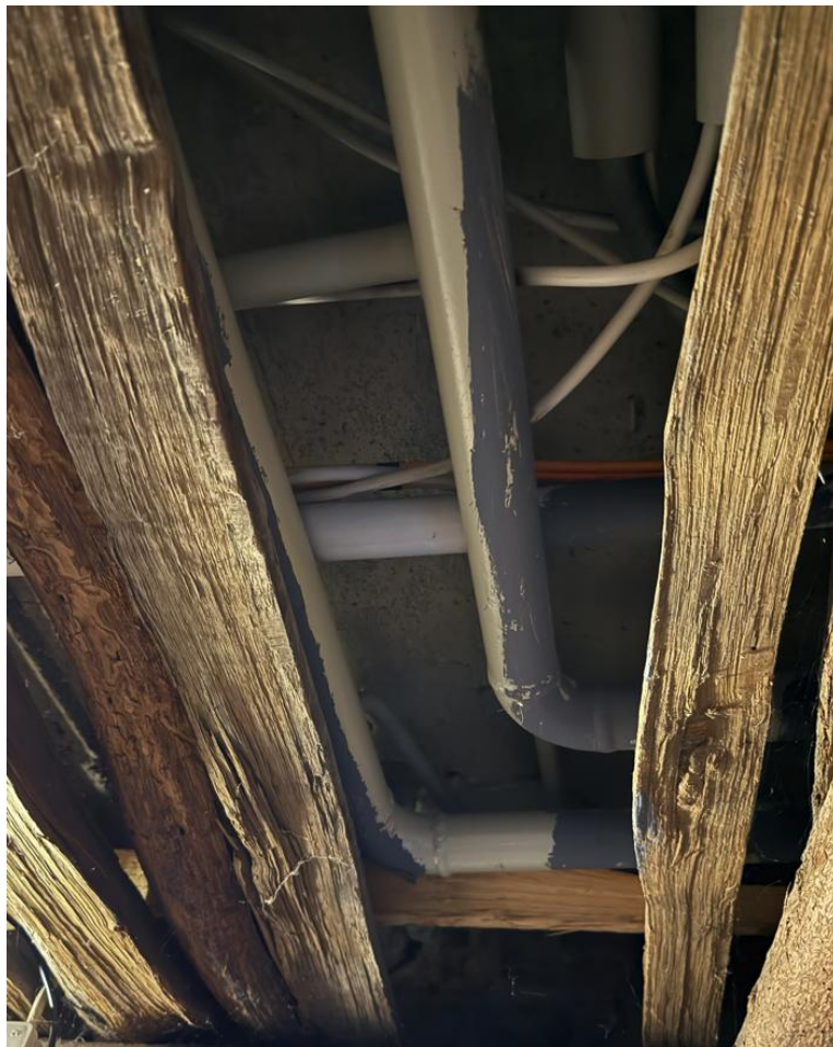
Abbildung 9 Ungedämmte Leitungen unter der Decke Haus 1
