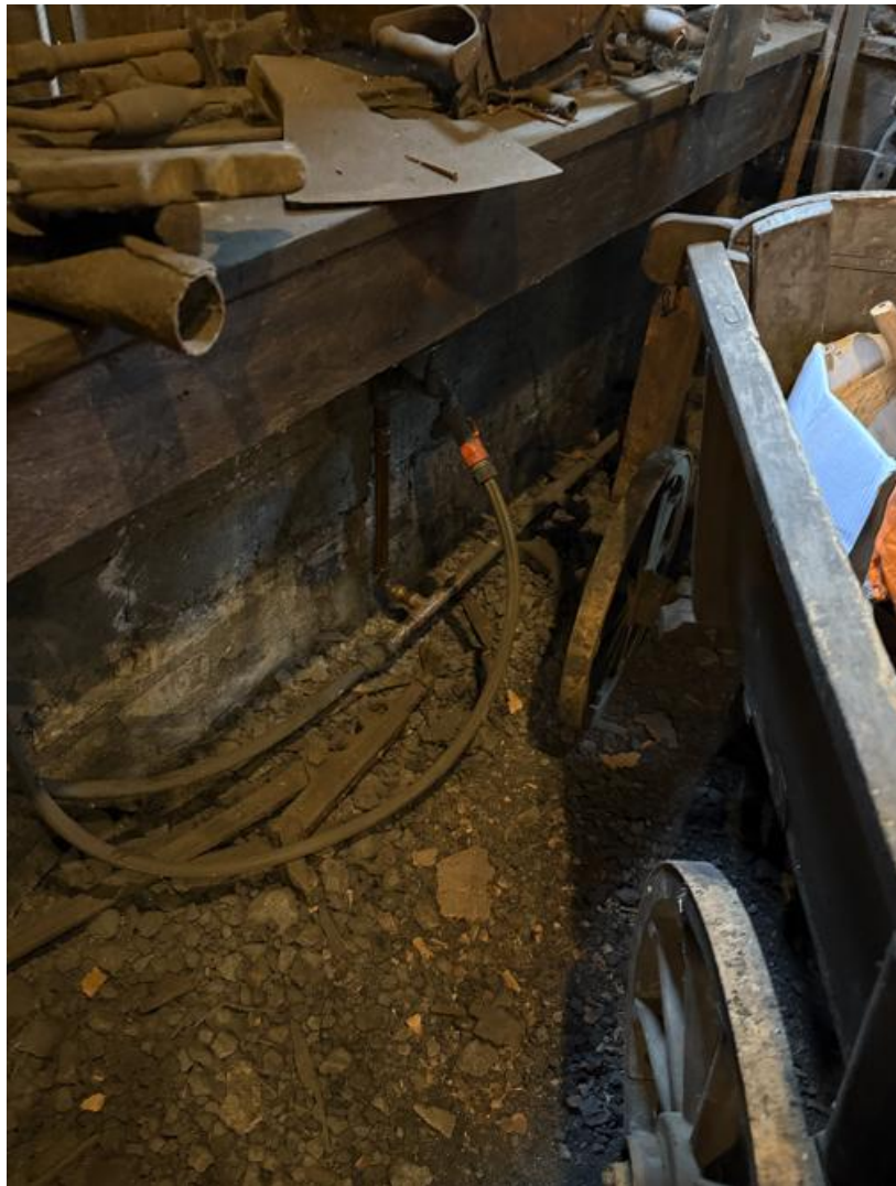
Abbildung 15 TW Leitung im Raum Hammerwerk
