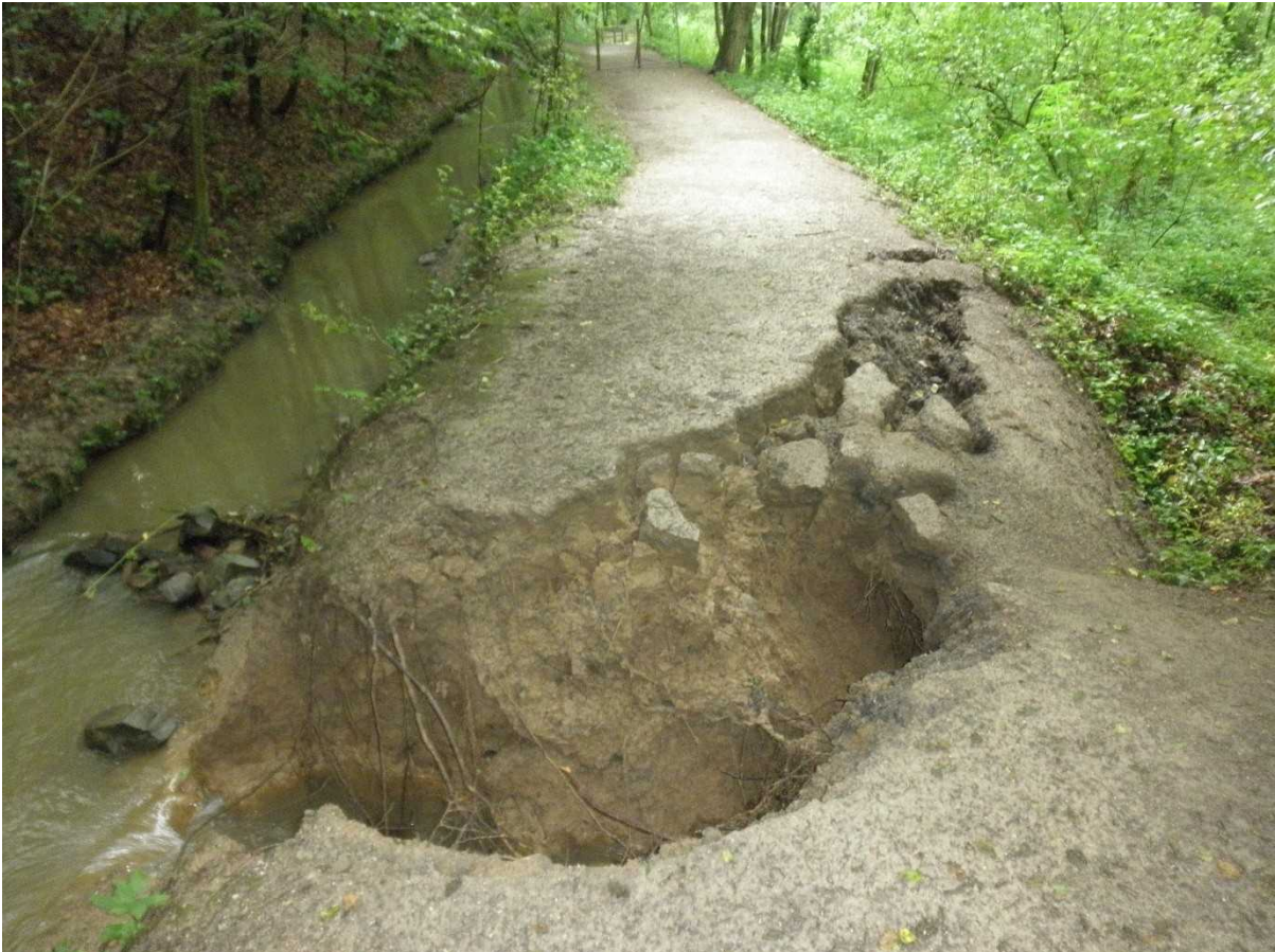
Abbildung 1: Einbrüche des Wanderweges
