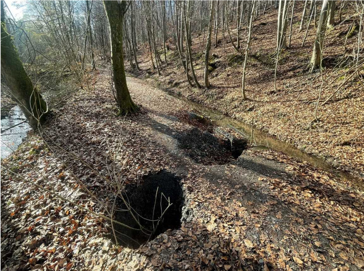
Abbildung 2: Einbrüche des Wanderwegs
