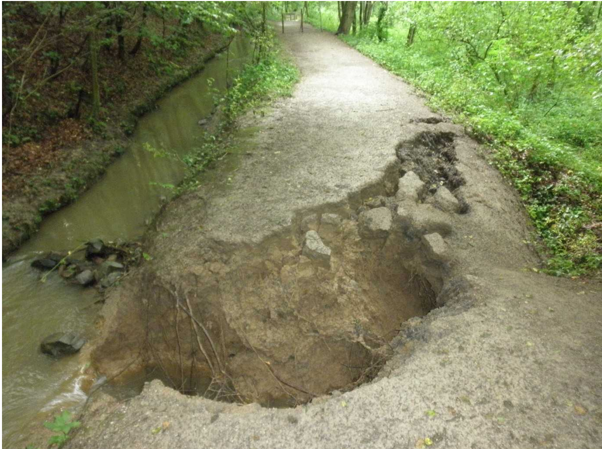
Abbildung 1: Einbrüche des Wanderweges
