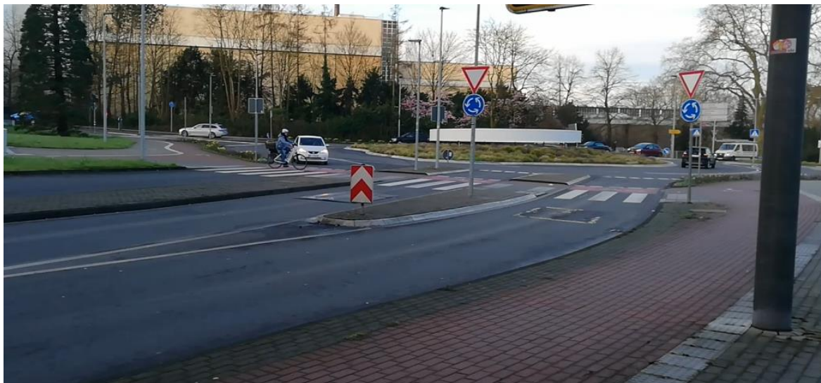
Bild 18: Berliner Kissen rechte Zufahrt Schnabelsmühle defekt
