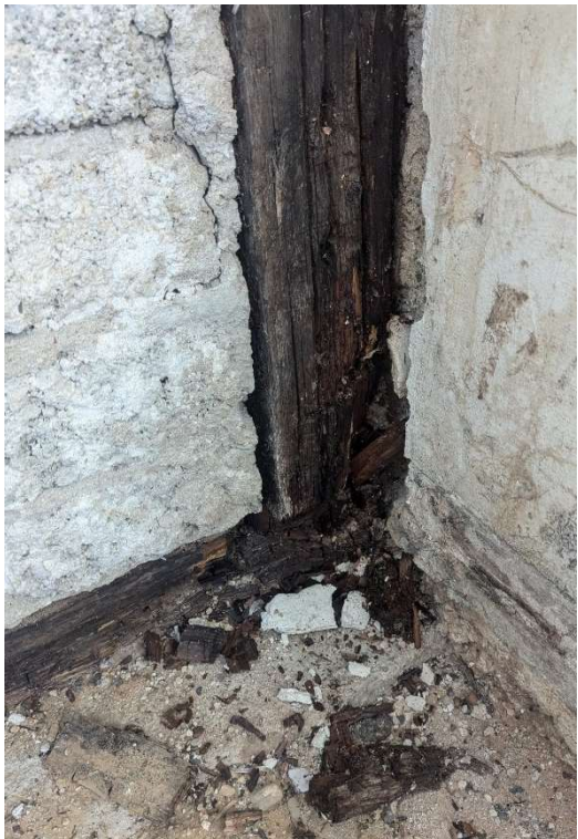
Alter Wasserschaden – Pilzbefall
