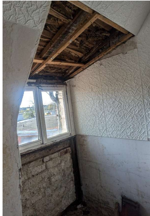
Alter Wasserschaden - Pilzbefall
